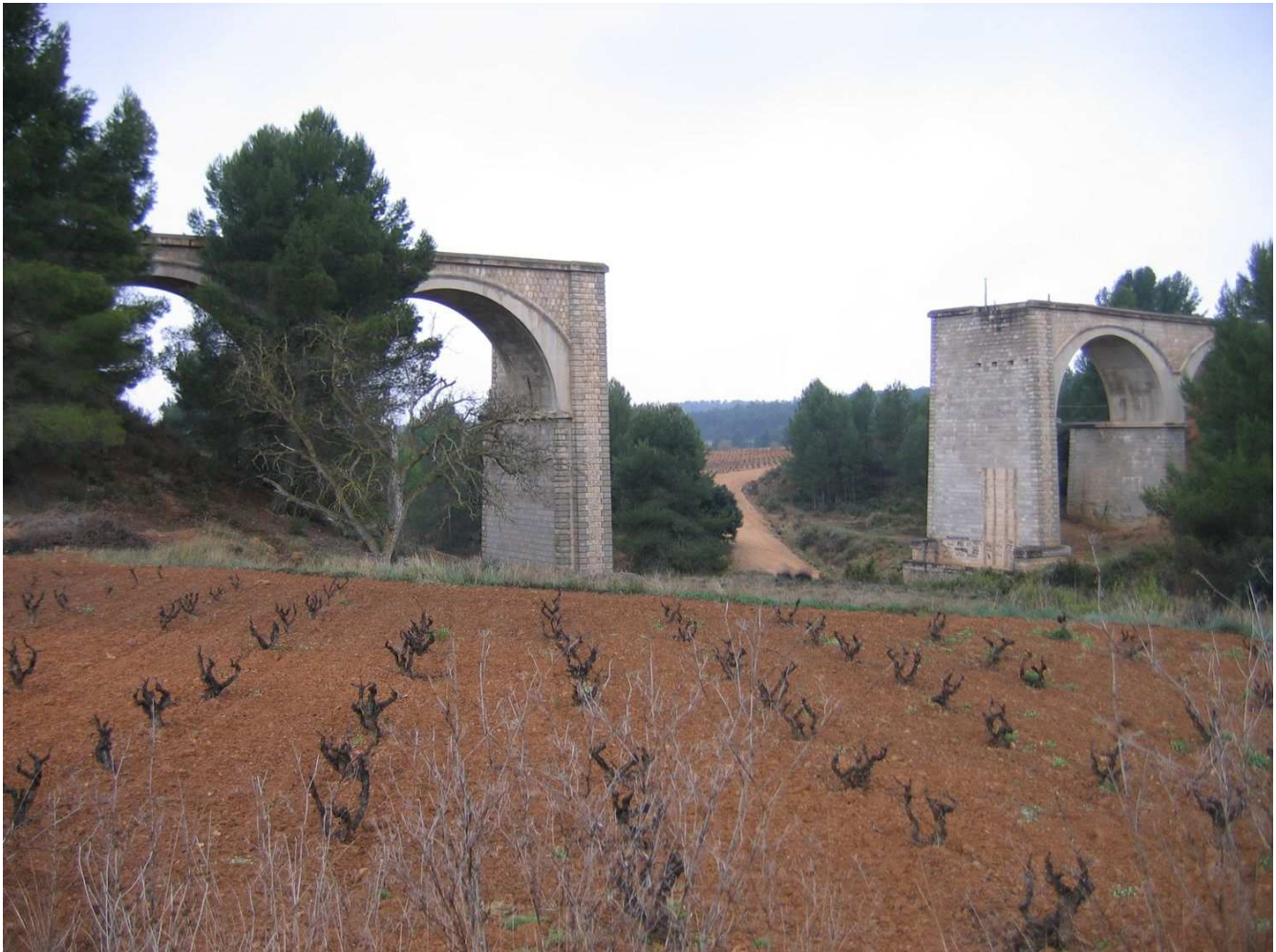
Puente de la línea Utiel-Baeza que salva la rambla Bullana (Venta del Moro)
